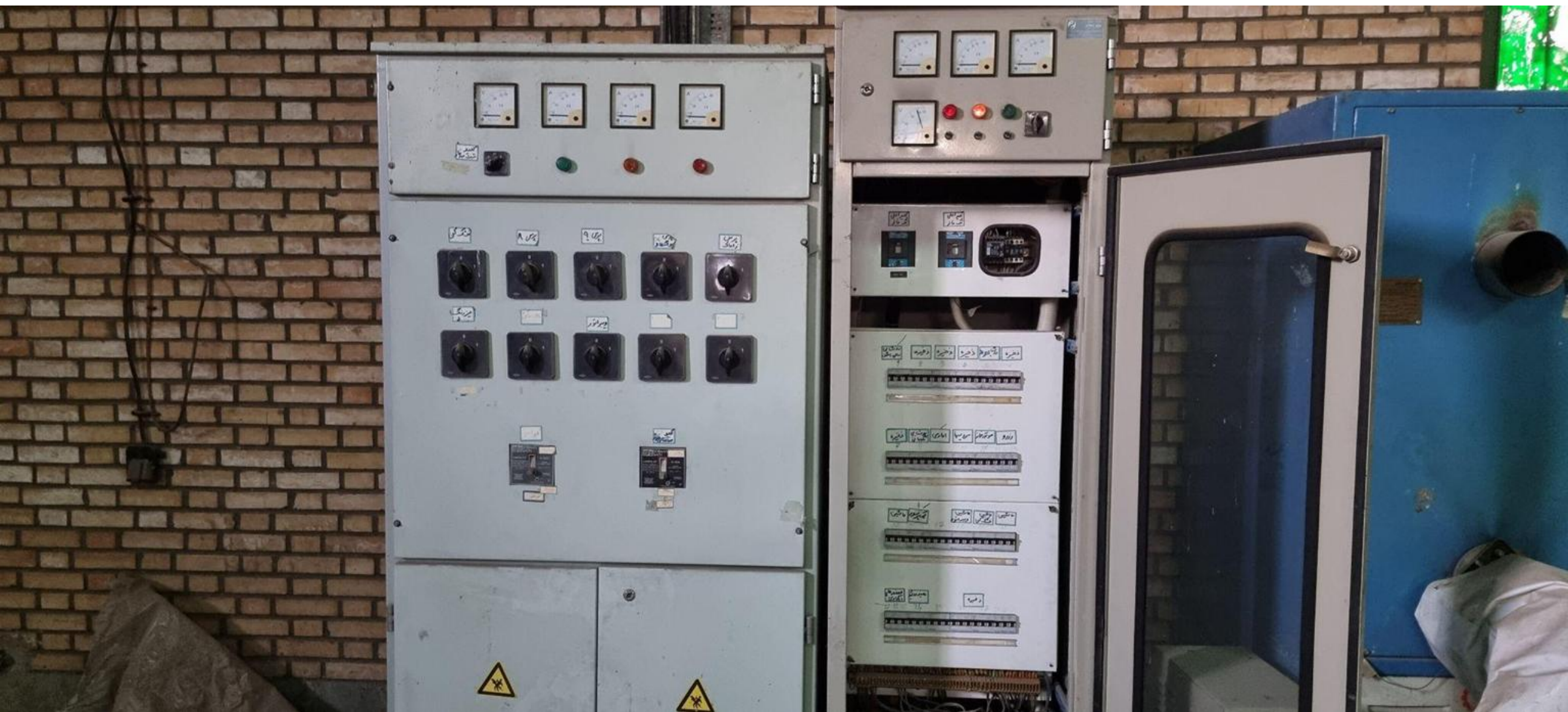
داخل انبار با تاسیسات
